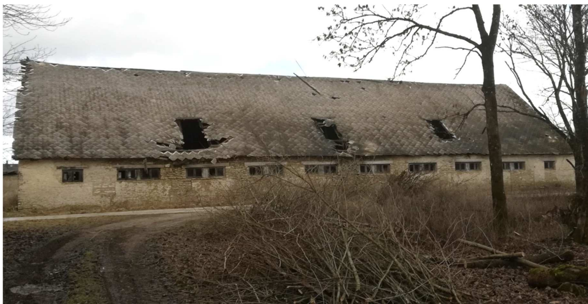
Foto 71. Vaade endise esiväljaku kohal oleva haljasalaga idaservast piirnevalt teelt endise lauda kagupoolsele küljele, hoone katus on osaliselt sisse kukkunud. 2020. Foto: Toomas Põld
