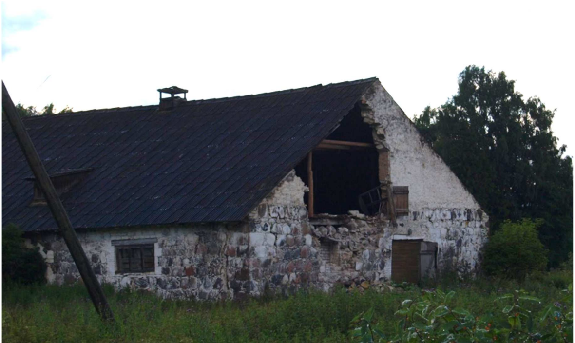
Foto 72. Vaade Mõisa teest kaugemale jäävale lauda kagupoolsele küljele, mille maakividest müüridelt on krohv maha tulnud ja hoone otsafassaad on osaliselt sisse kukkunud. 2009. Foto: Tõnu Õnnepalu 62
