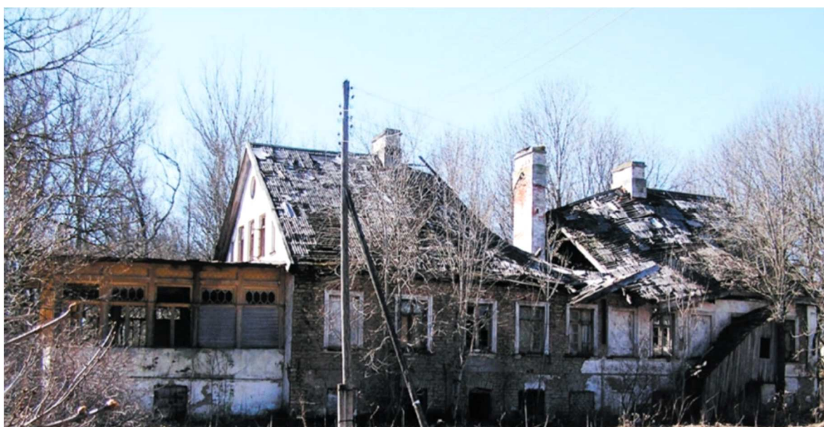
Foto 65. Osaliselt sisse varisenud katusega mõisa peahoone põhja-kirdepoolne külg. 2015. Foto: Raivo Kannik 58
